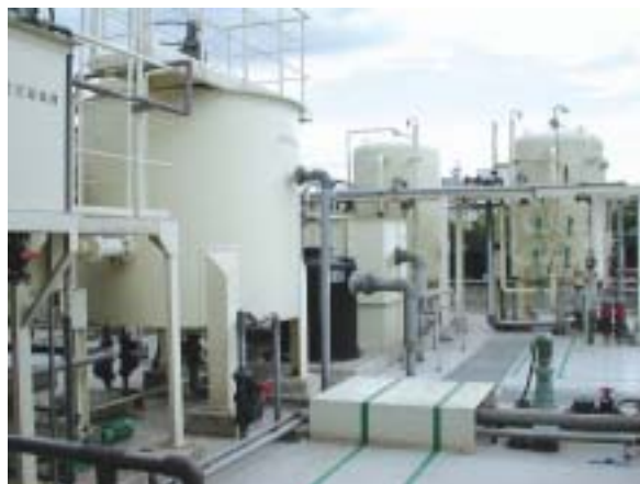
藤沢製作所の総合排水処理センター
