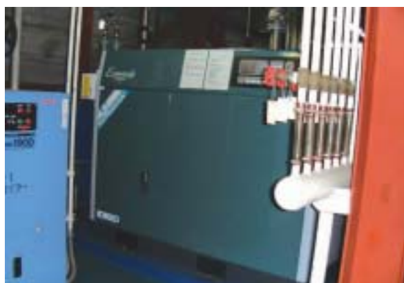
浜松製作所が導入したインバータ式空気圧縮機
