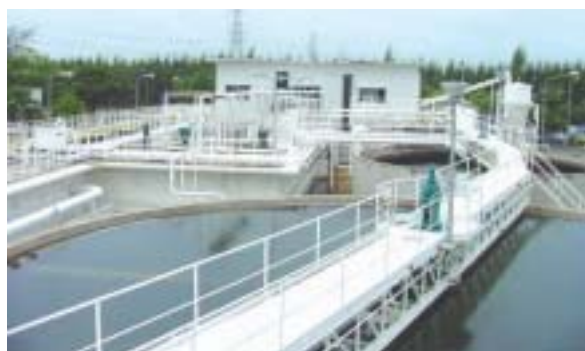
タイ / バンバイン工場の排水処理施設
