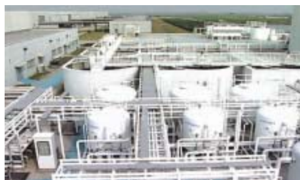
中国 / 上海工場の排水処理施設
