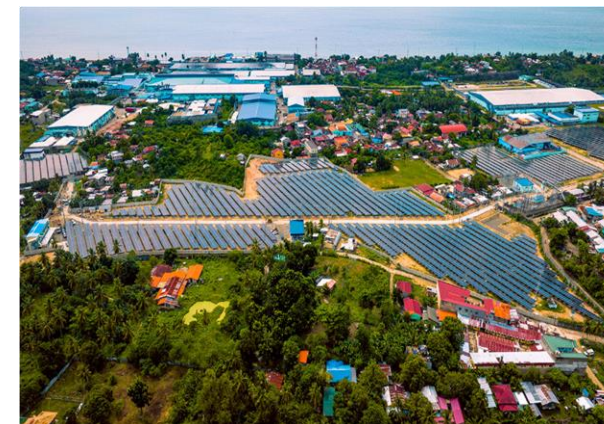
セブ工場に設置した太陽光発電パネル
