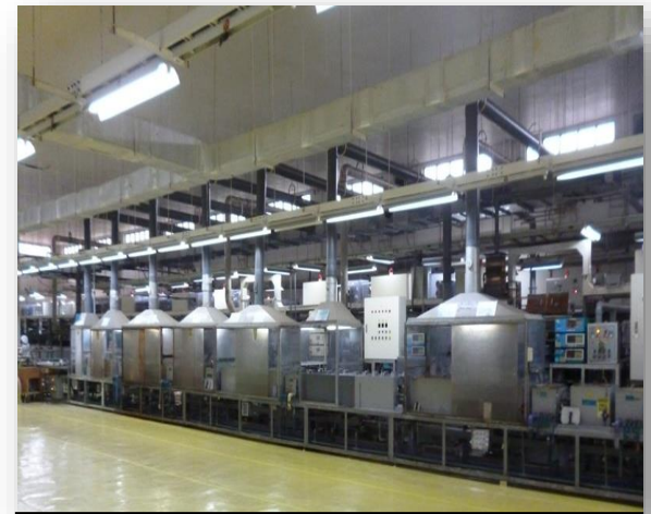
フープめっきライン
