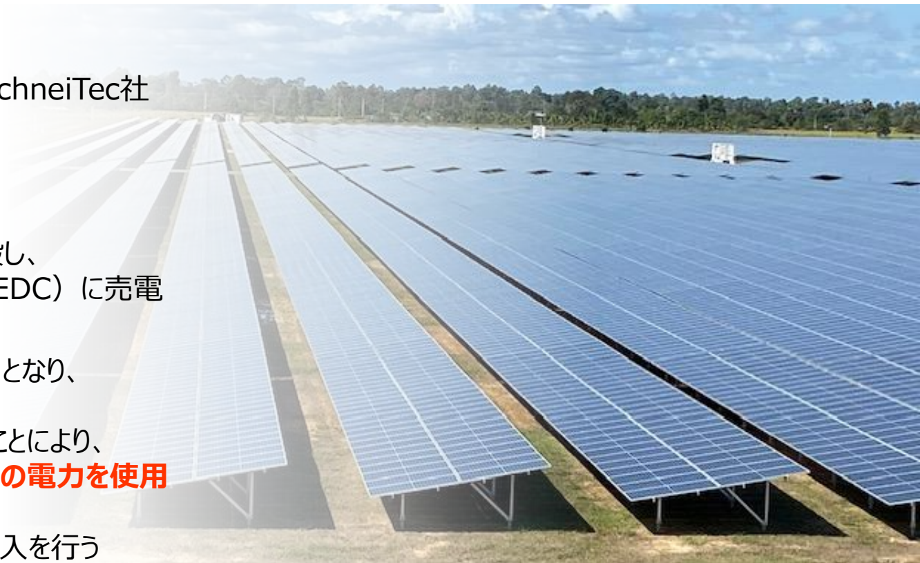
SchneiTec社にて設置済みの太陽光発電システム
